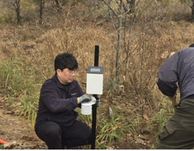
데이터로거 및 온습도센서 설치
